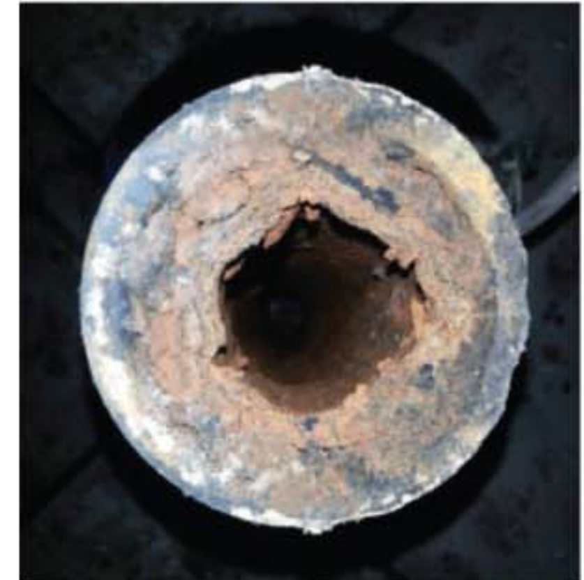
รูปตะกอน และสนิมอุดตันภายในท่อเหล็ก
